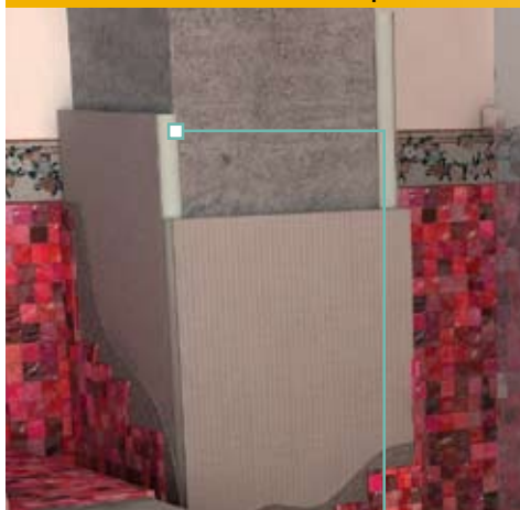
Particolare rivestimento del pilastro
